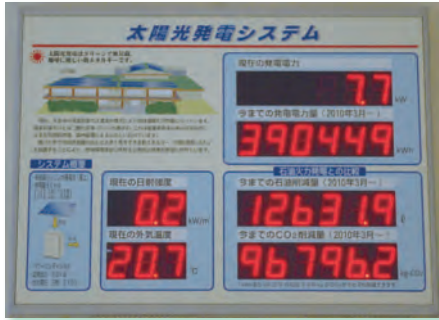
太陽光発電システムパネルの表示
